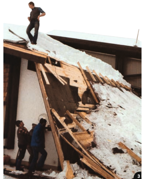
3 Zu hohe Schneelasten ließen diesen Dachvorsprung wie ein Kartenhaus einknicken
